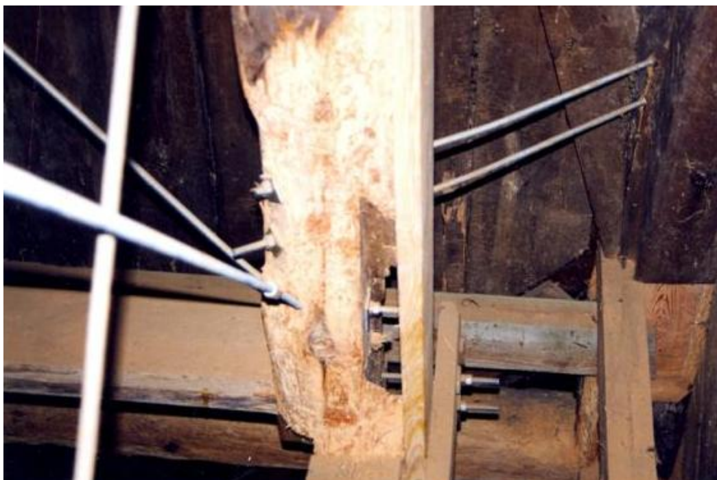
Skartowanie i wzmocnienie mocno skorodowanych słupów wieży. Pułtusk.
