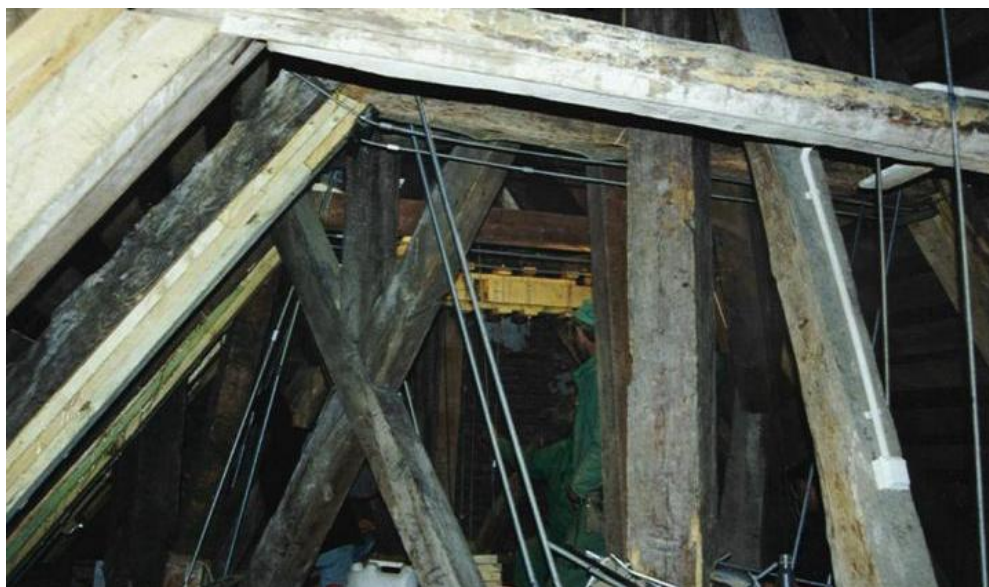
Konstrukcja pod wieżą w bazylice pułtuskiej. Nowe elementy nośne doklejone do starych krokwi.
